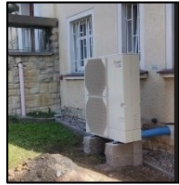
Nové tepelné čerpadlo
